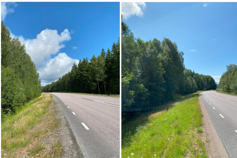
Figur 3-22. Diken för avvattning vid delåtgårdsområde 2. Höger: Norrgående riktning, västra diket. Vänster: Södergående riktning, östra diket (Foto: Sweco).
